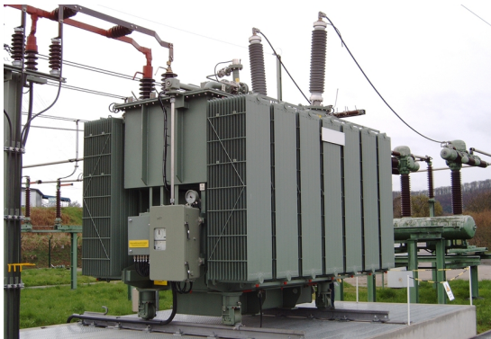
Fig. 4. Transformador de potencia.
