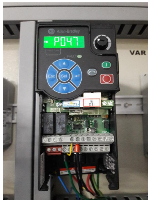
Fig. 9. Variador de frecuencia.
