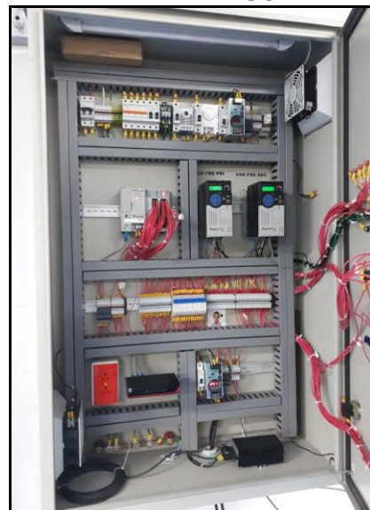
Fig. 7. Tablero de control del sistema de riego
