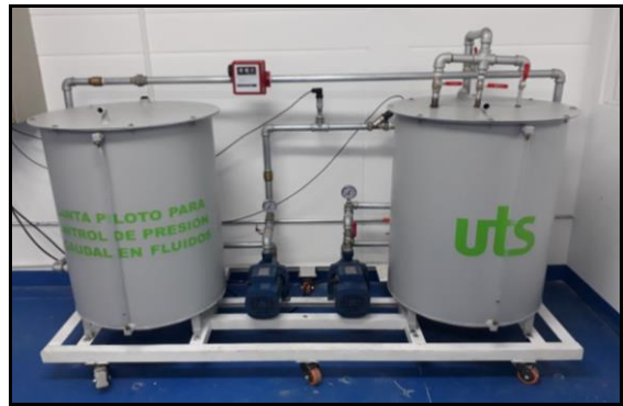
Fig. 6. Planta piloto para control de fluidos
