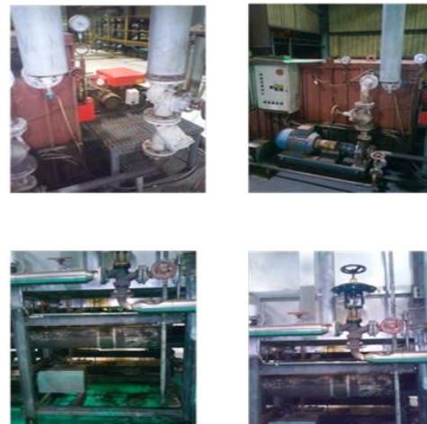
Figura 2: Imagen de la caldera de la freidora de papas
