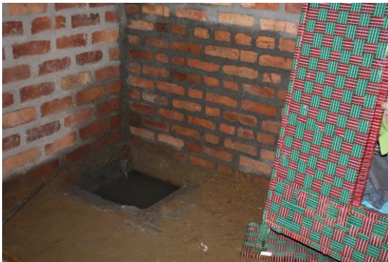
Fig. 3. Afloramiento de agua en la base de la terraza media de la ladera. Fuente: Autor
