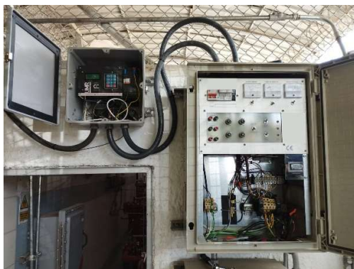
Fig. 10. UMR Implementada sobre rectificador de protección catódica
