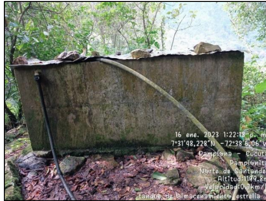
Ilustración 9. Tanque de almacenamiento.
