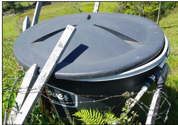
Ilustración 9. Tanque de almacenamiento “La Tigra”.
