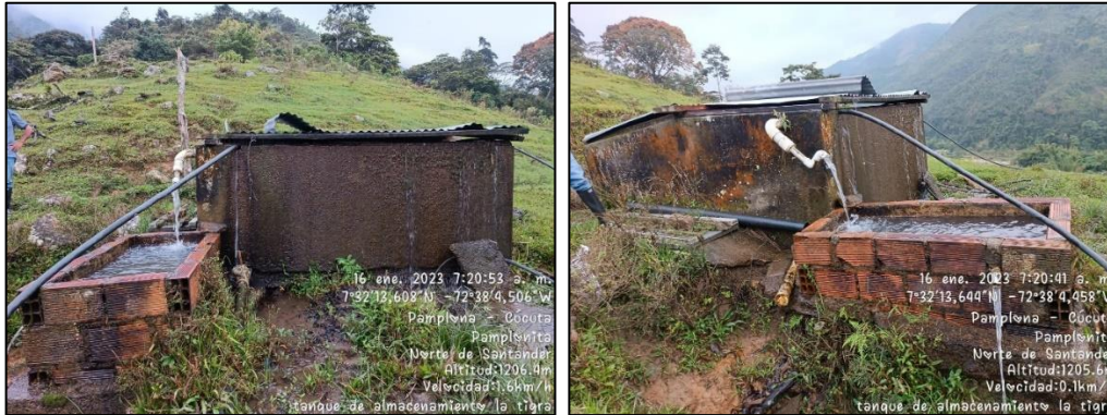
Ilustración 8. Tanque de almacenamiento “La Tigra”.
