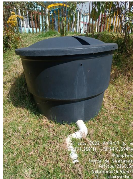
Ilustración 13. Tanque de almacenamiento.
