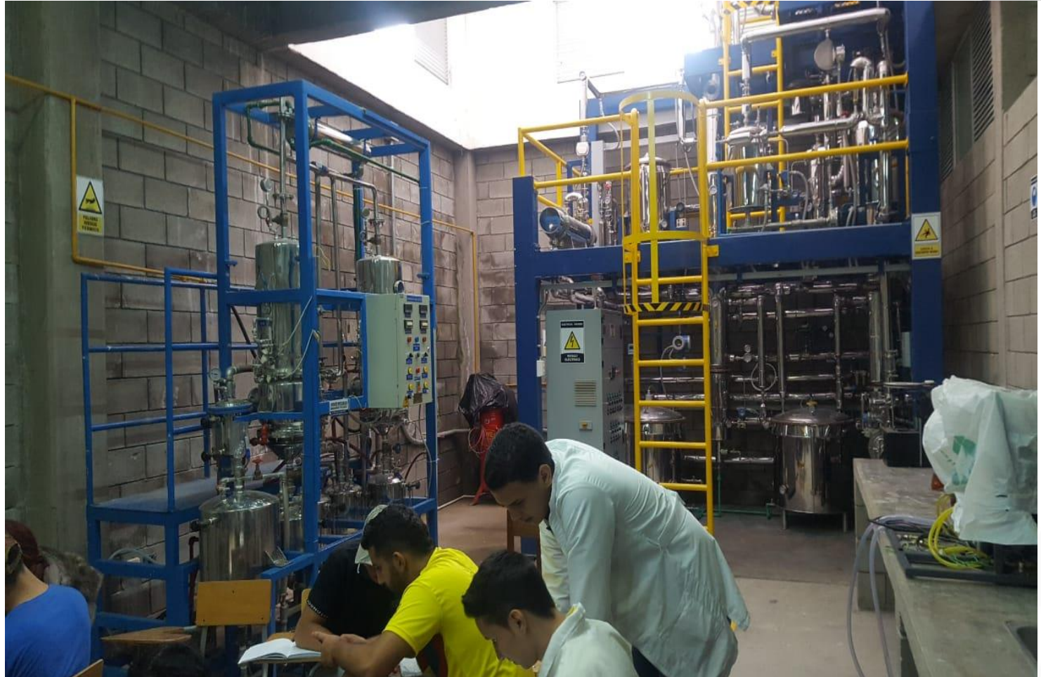
Planta piloto de Procesos químicos
