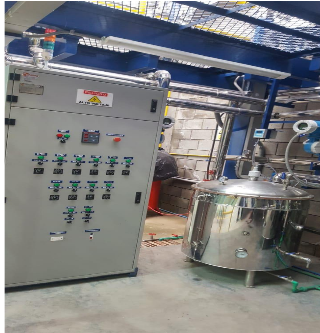
Panel de control y monitoreo
